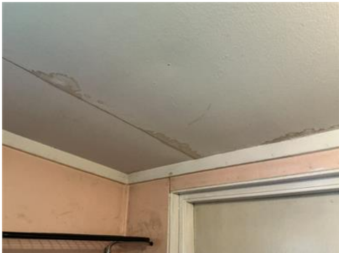
Fuktfläckar på innertak i garage.
