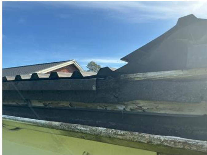
Rötskada i läkt vid takfot på garage.
