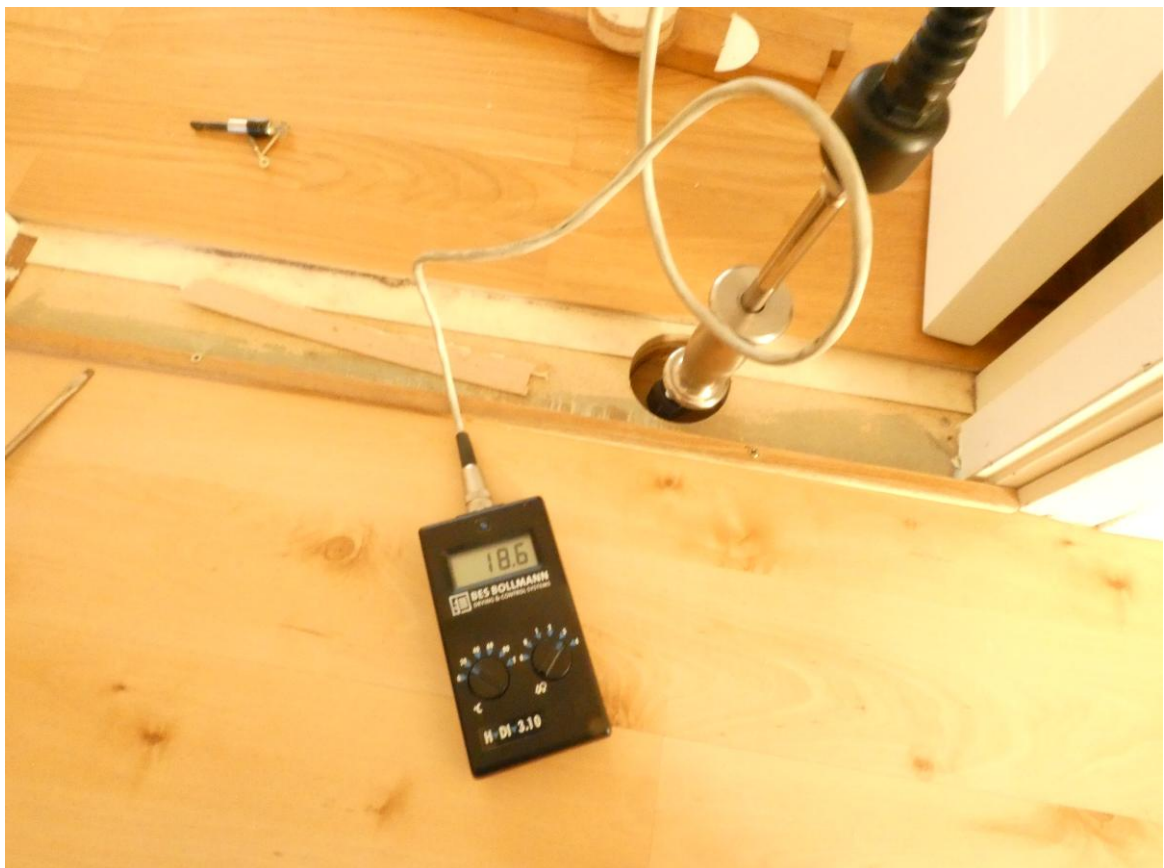
Mp 2. Fuktkvotsmätning av regel under bärande vägg, avvikande hög fuktkvot noteras
